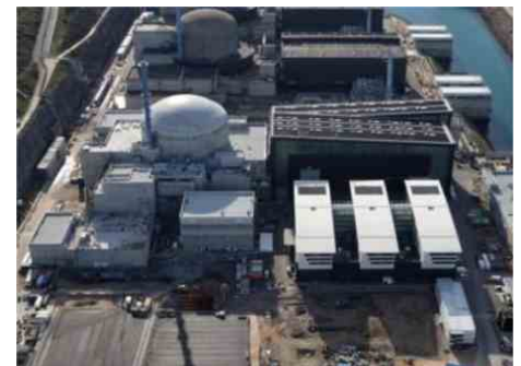
Framatome accompagne EDF pour la réalisation et la mise en service du réacteur EPR de Flamanville.
